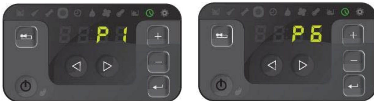
Slika 29: Prikazuje vremena za programirani rad kotla
